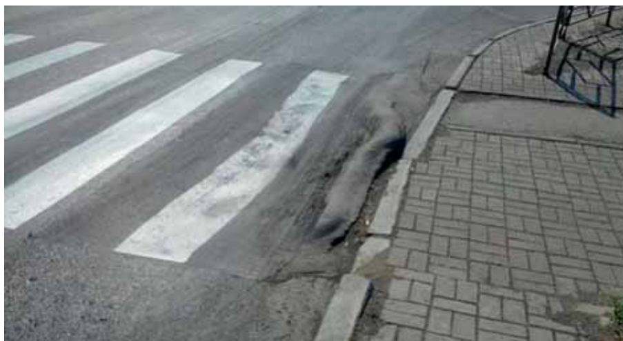
Рис. 1. Пластические деформации покрытий из литого асфальтобетона
