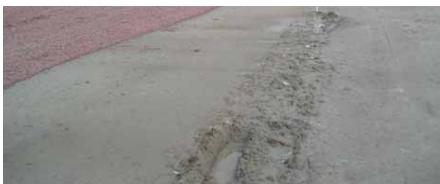
Рис. 5. Разрушение конструктивного слоя из стабилизированного грунта от подвижной нагрузки после водонасыщения
