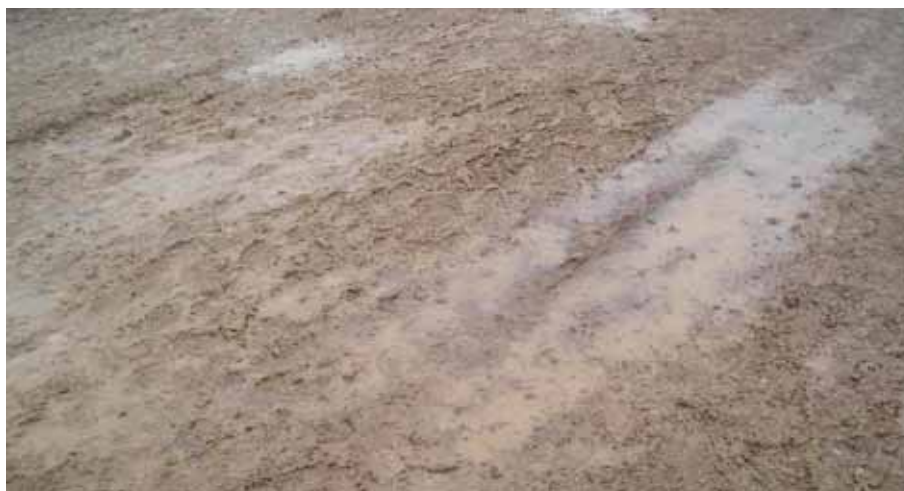
Рис. 4. Слой дорожной одежды из стабилизированного грунта после выпадения осадков
