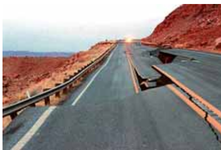
Рис. 17. Разрушение дорожной одежды с асфальтобетонным покрытием по причине потери опоры на грунтовое основание, размытое в результате фильтрации воды
