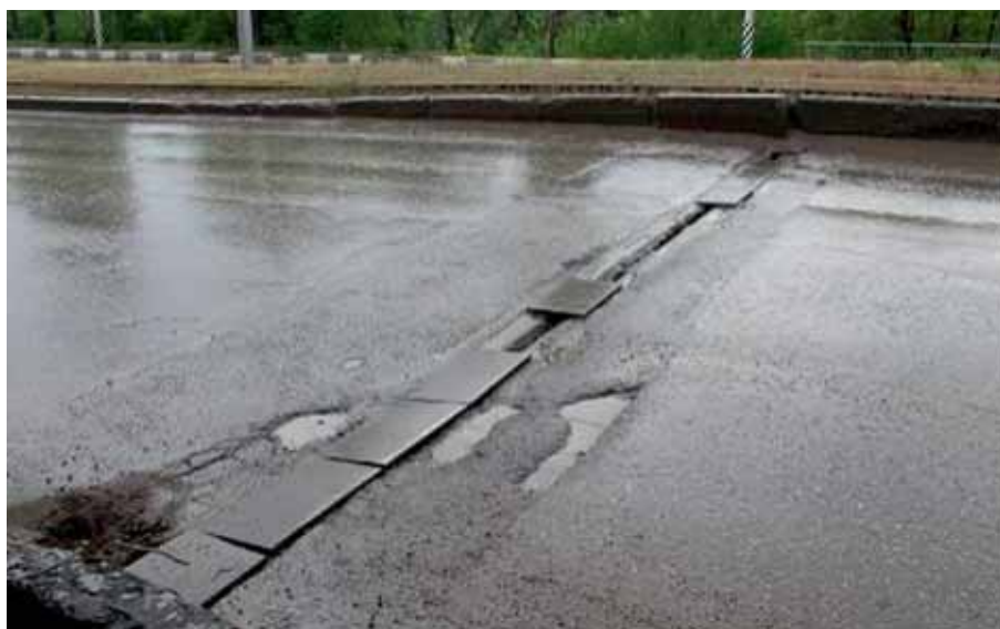
Рис. 2. Разрушение асфальтобетонного покрытия в зоне работы деформационного шва
