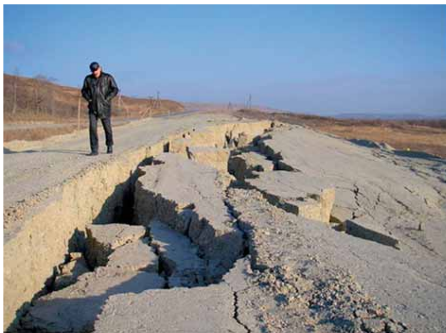
Рис. 3. Разрушение частично отсыпанной насыпи на слабых грунтах
