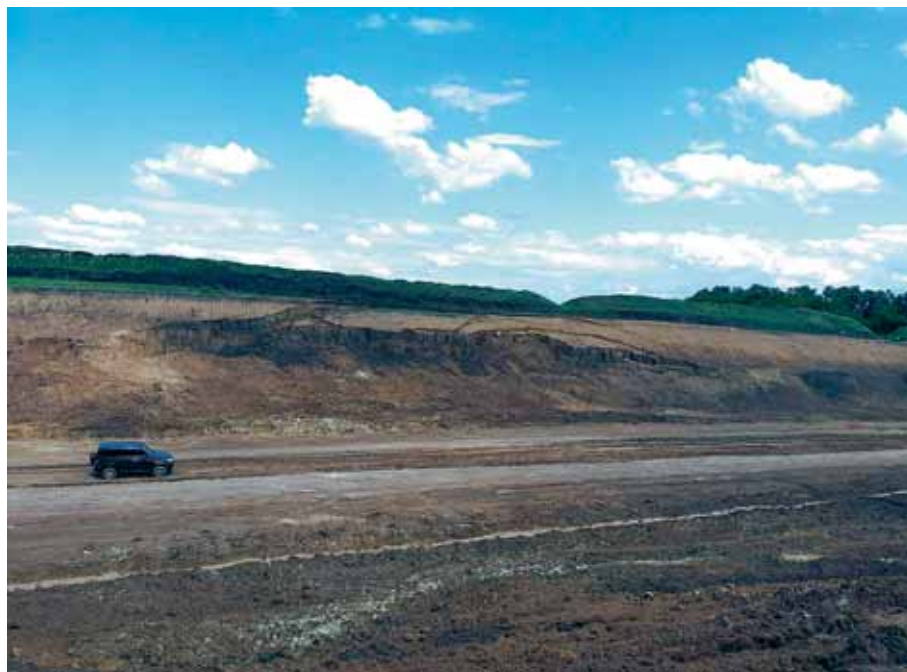
Рис. 2. Обрушение борта выемки в твердых глинах (фото автора)
