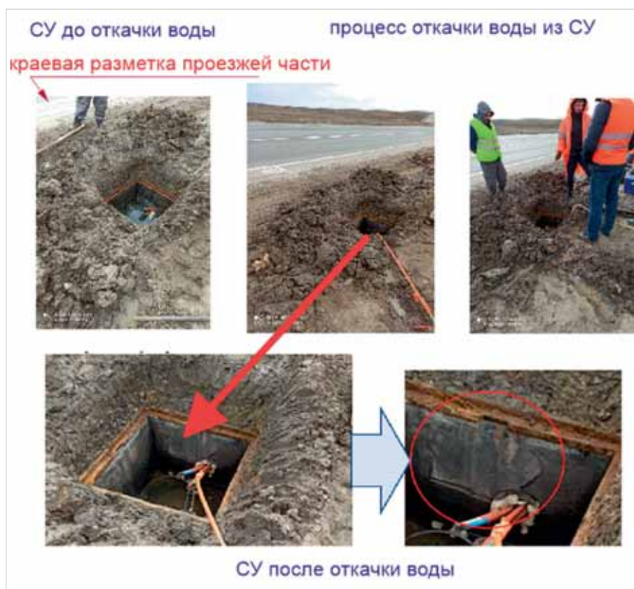
Рис. 5. Затопление и повреждение СУ в обочине автомобильной дороги Р-229 Самара - Пугачев - Энгельс - Волгоград (НК ЛКС ТМК № 13, км 12+694)
