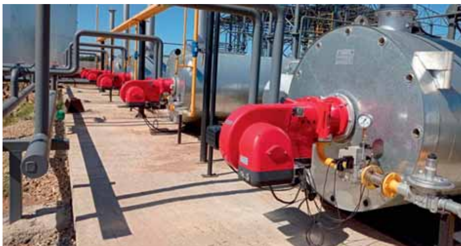
Битумный терминал 80 000 т., Орловская область (фото представлено компанией «ПРОМСЕРВИС»)
