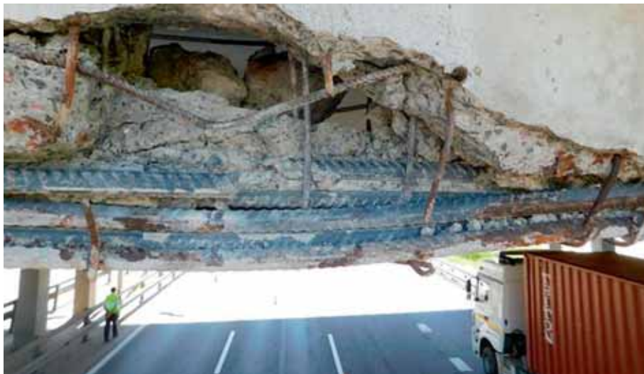
Рис. 1. Разрушение ребра железобетонной балки пролетного строения от удара, трасса М-4 «Дон»
