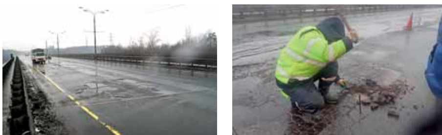
Рис. 6. Разрушение покрытия на путепроводе на км 53+800 автомобильной дороги М-7 «Волга» в Московской области (направление в область) после года ремонта
