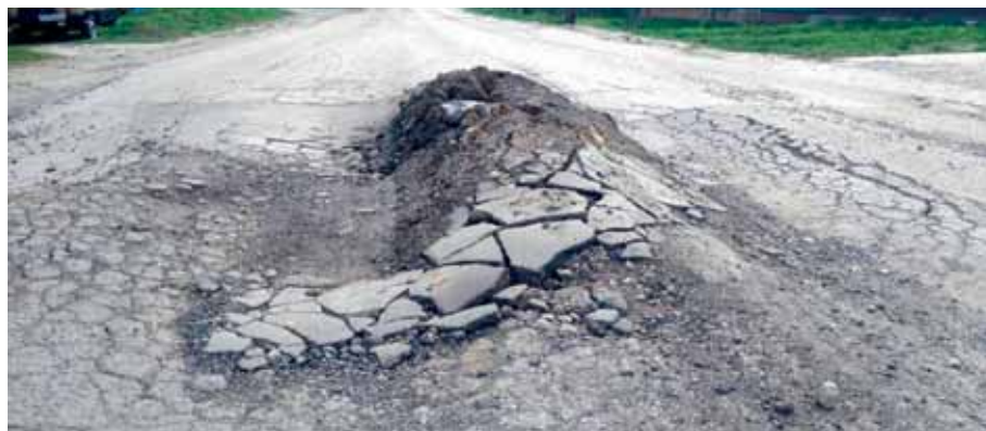
Рис. 1. Разрушение асфальтобетонного покрытия дроблением и путем продавливания с проломом в месте переувлажнения грунта земляного полотна
