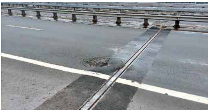
Фото 15, 16. Дефект «На границе плотностей»
