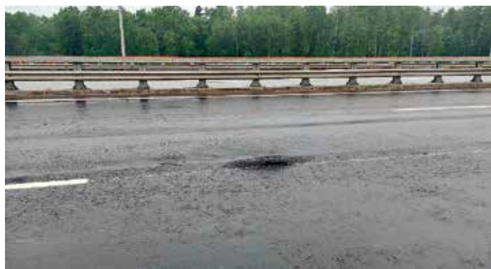
Фото 8, 9. Дефект «Несоответствие смесей условиям работы»
