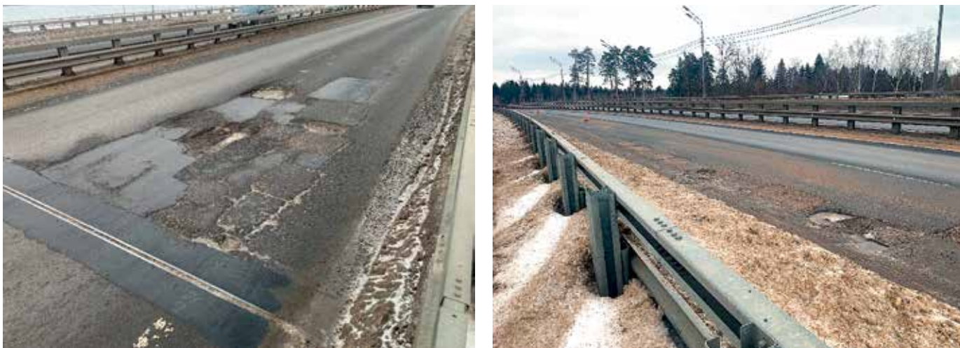
Фото 6. Разрушение асфальтобетонного покрытия (полоса находится в водонасыщенном состоянии)
