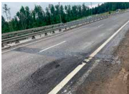
Фото 10. Дефект «Низкокачественное битумное вяжущее». Покрывание находится в водонасыщенном состоянии
